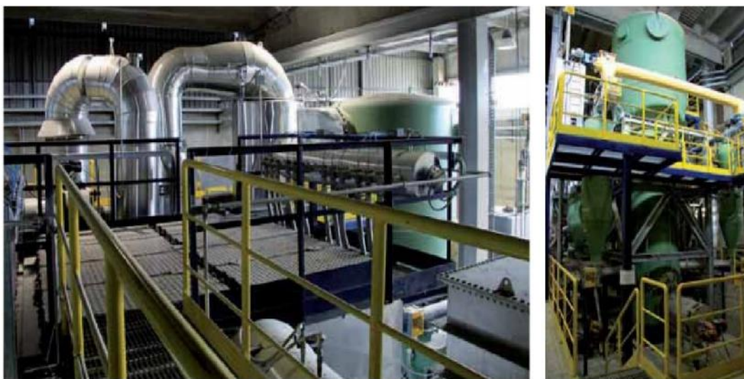
Vista interior instalaciones de EBIOSS Energy (SYNGAS Italy) en la Toscana Italiana
