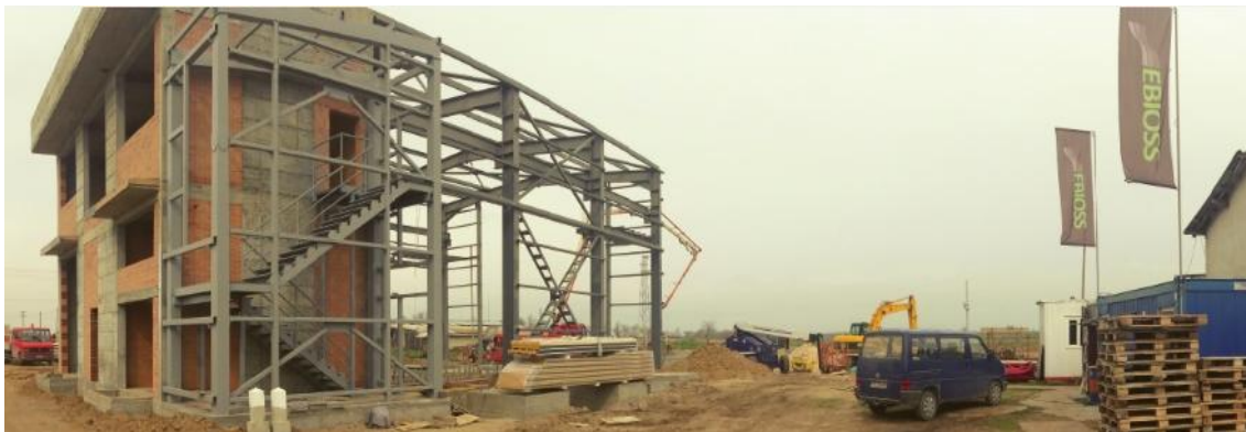
Estado de la obra civil 1ª Fase (Marzo 2014) Karlovo Biomass en Stroevvo (Bulgaria)
